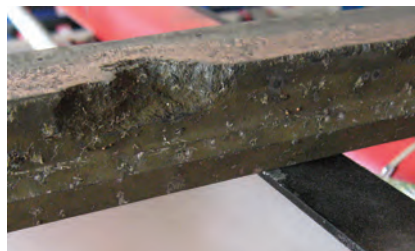
图3: 该系统检查出一段金属不安全，需要维修。
